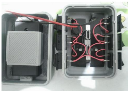
Fig. 2 - Instalação elétrica do dispositivo.
